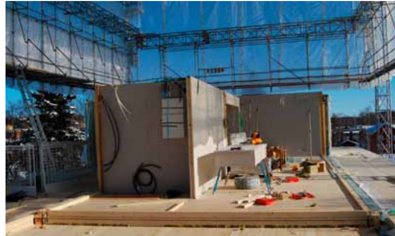
Figur 7 Köks- och badrumsvolymer monterade på ett våningsplan i hus med bärande planelement.
